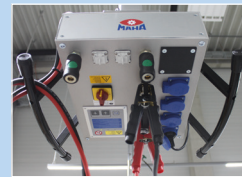
Hebebühnensteuerung, Energieversorgung, Druckluft und Datensteckdose auf der Unterseite platziert.
